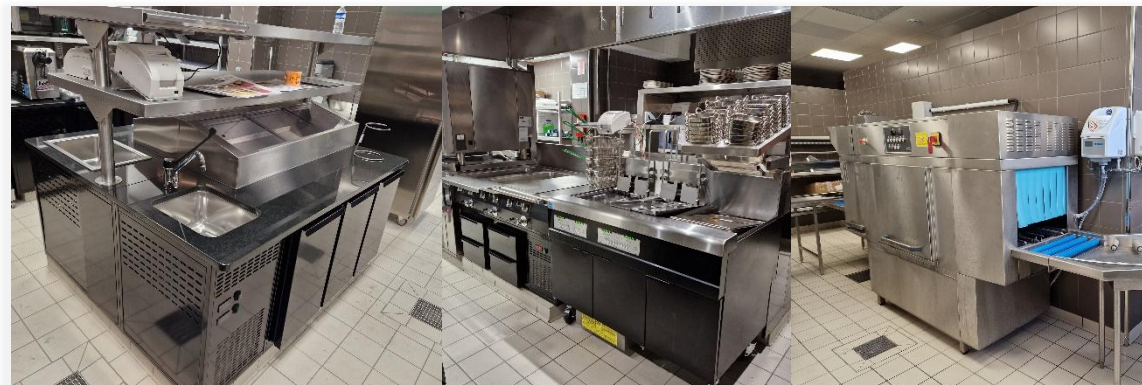
3 Brasseurs Valvert - Cuisine, Préparation et Laverie - 2026
