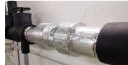
Ibis budget München Messe Ost H5626 – Isolierung diverser Leitungen
